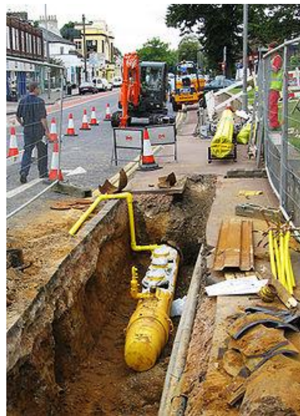
Plynové potrubí z PE
